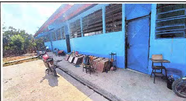
Foto 3: Se observa las puertas completamente corregidos en el modulo 1
